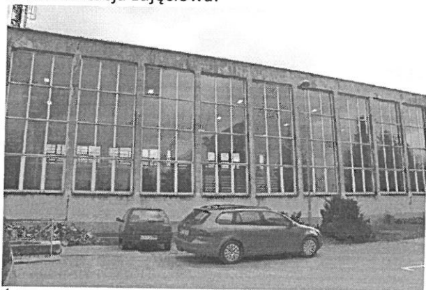
Ściana W Sali gimnastycznej
