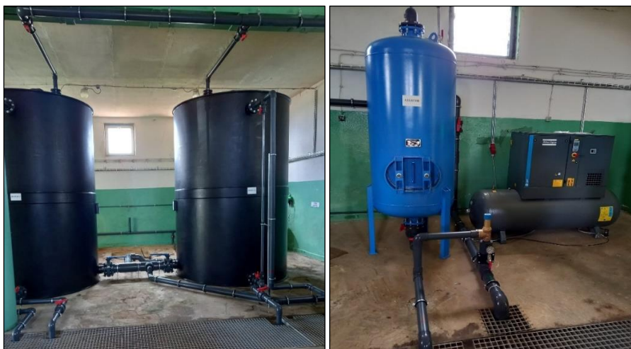
Urządzenia technologiczne w SUW w Brudzewicach
