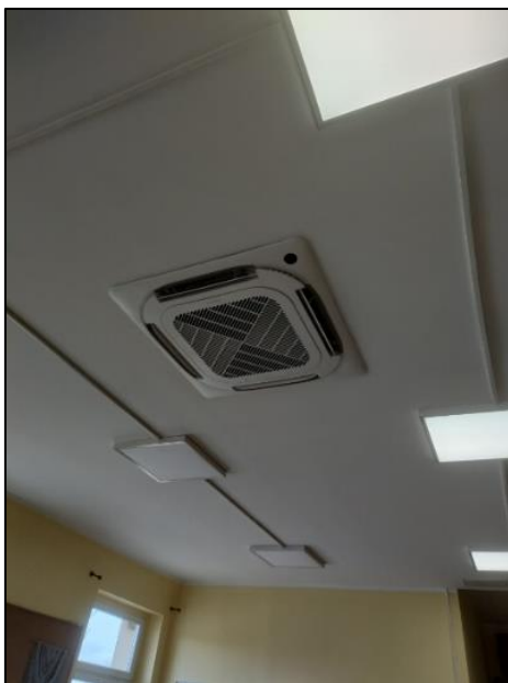
Klimatyzator w świetlicy w Tarnowie
