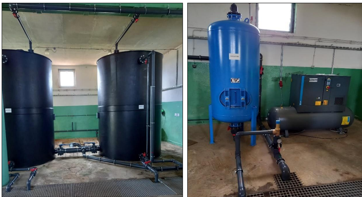
Urządzenia technologiczne w SUW w Brudzewicach
