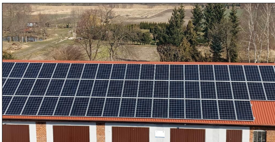
Instalacja fotowoltaiczna na budynku gospodarczym UM w Suchaniu
