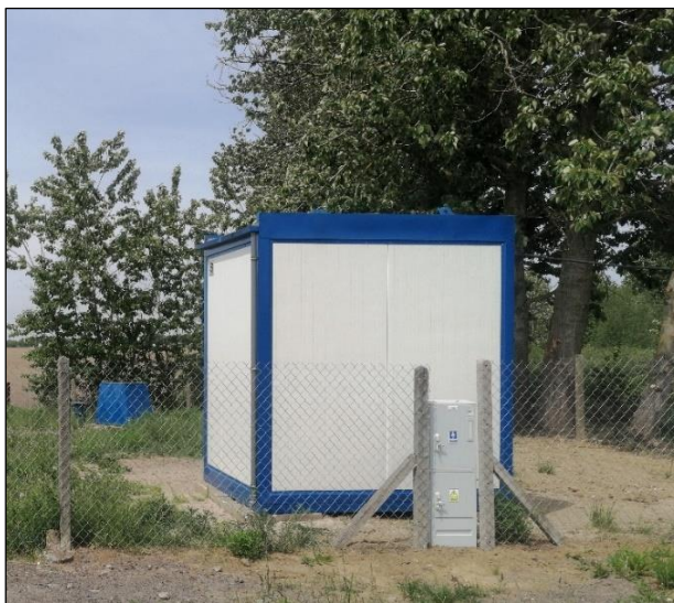
Kontener techniczny w Wapnicy
